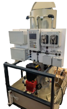
👍 STACJA UZDATNIANIA WODY TECHNOLOGICZNEJ PLEASE ClO 2
